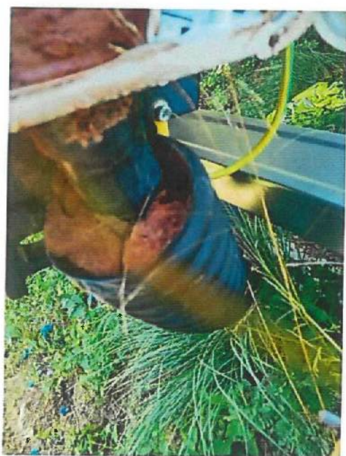
17-10逆变器外侧防火封堵需重 做。
