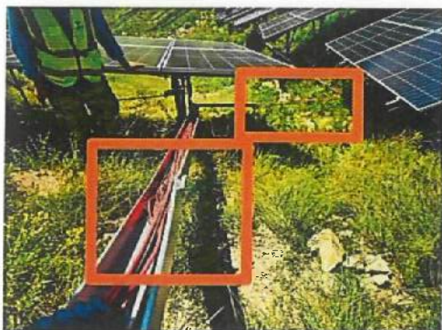
171019电缆桥架中间需加一组支架。
