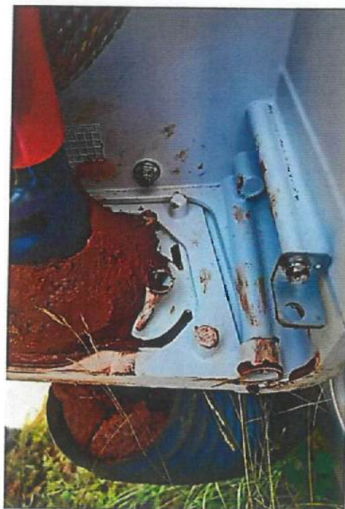
17-10逆变器内部防火封堵需从做
