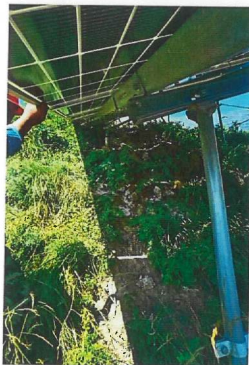
17-8-20混凝土未清理。
