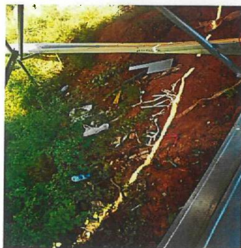
17区2号逆变器下部垃圾未清理。
