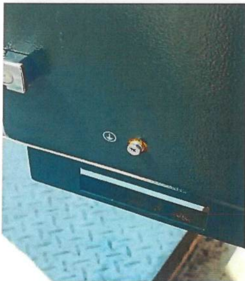
07箱变能量管理单元没做接地。
