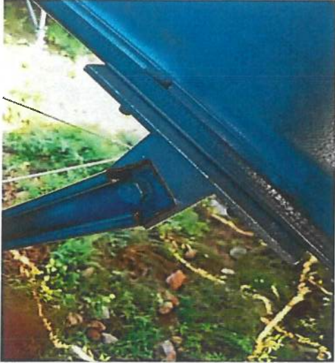
零七地块通病。支架生锈需要防腐。
