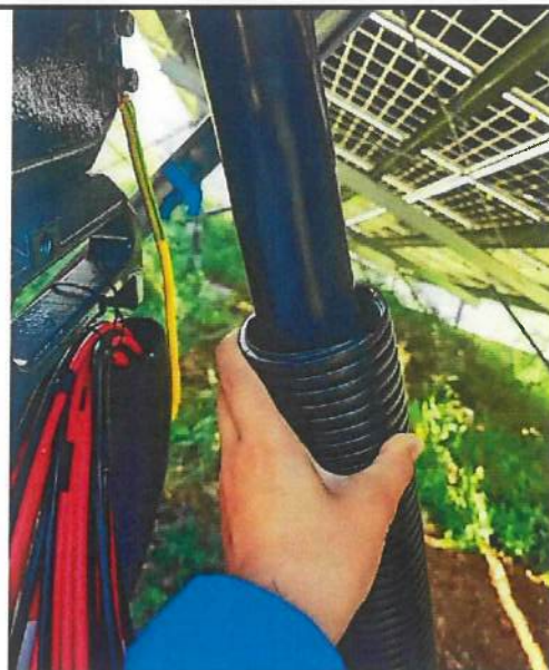
0703逆变器外部防火封堵未做。
