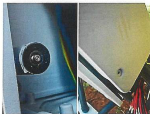
0703逆变器, 螺栓损坏。
