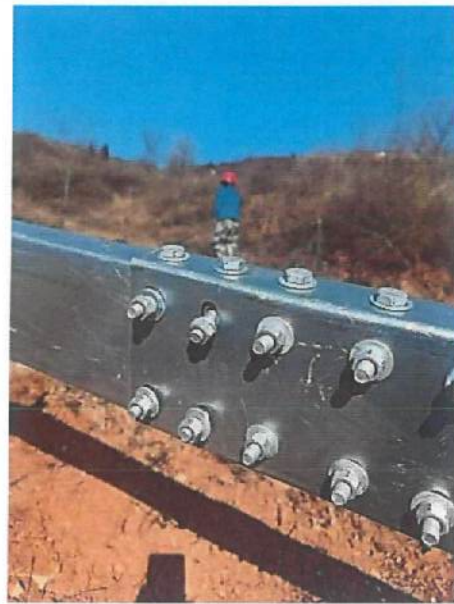
檩条连接处螺栓未紧固
