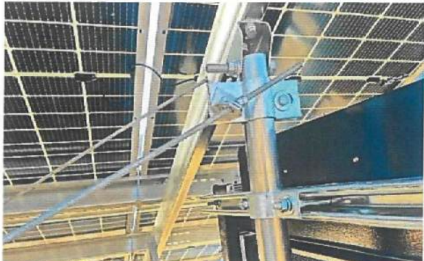
2、支架斜撑螺栓未紧固
