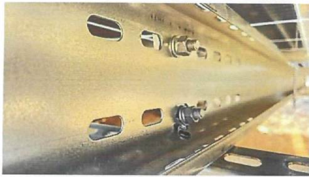
3、檩托与檩条连接螺栓安装不平整
