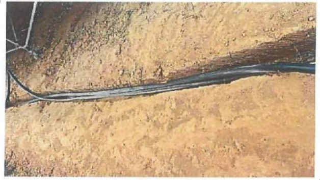
4、电缆沟坍塌未清理
