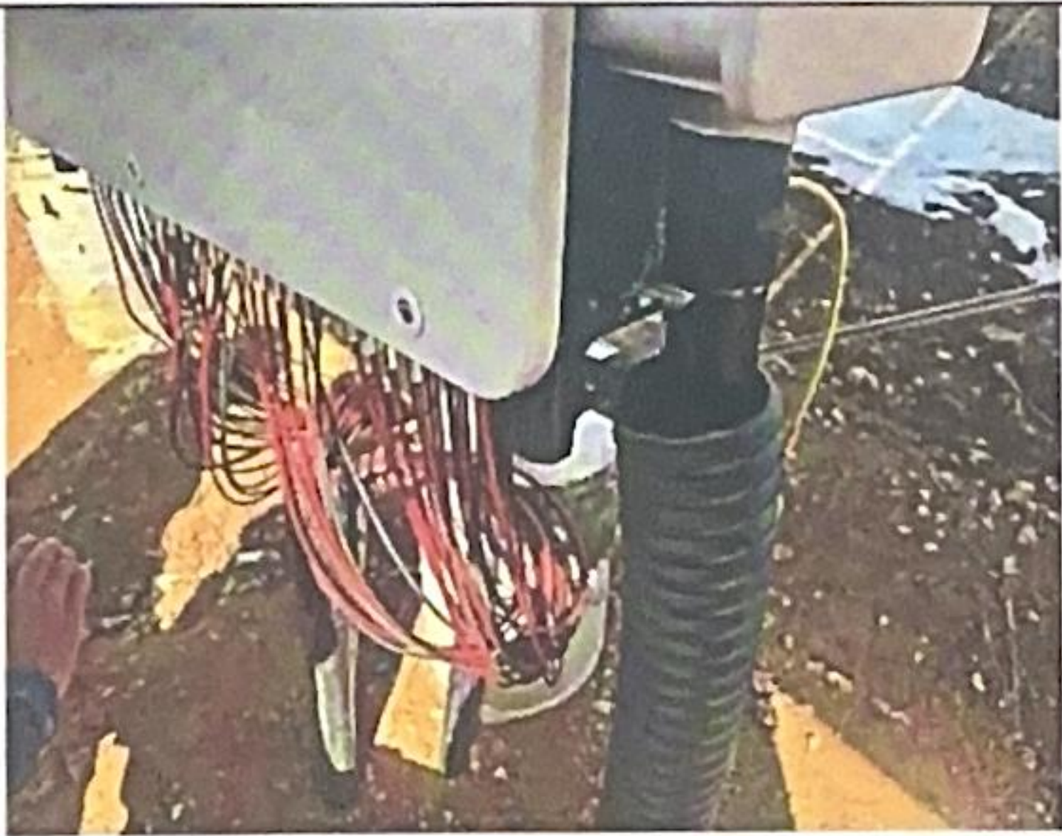
1、逆变器进线电缆防火封堵未制作
