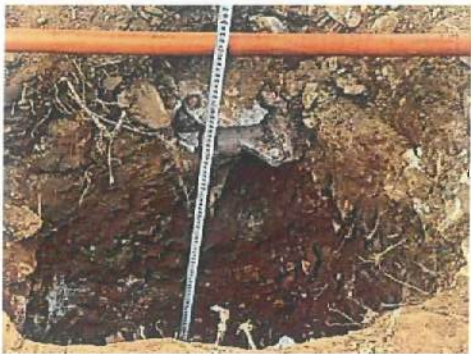
2、基坑坑壁不平整
