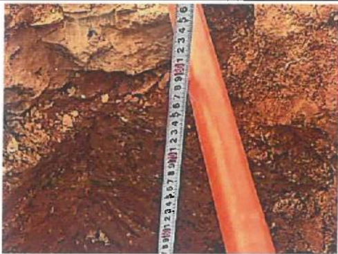
1、基坑深度不足
