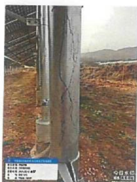
3、立柱镀锌层脱落
