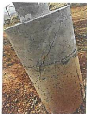
1、立柱二次灌浆开裂
