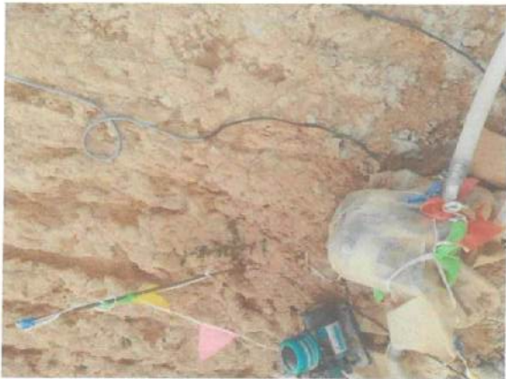
蓄水池抽水泵已取消插座改为由配电箱内开关控制
