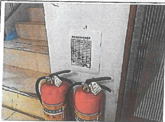
办公区域消防设施检查
