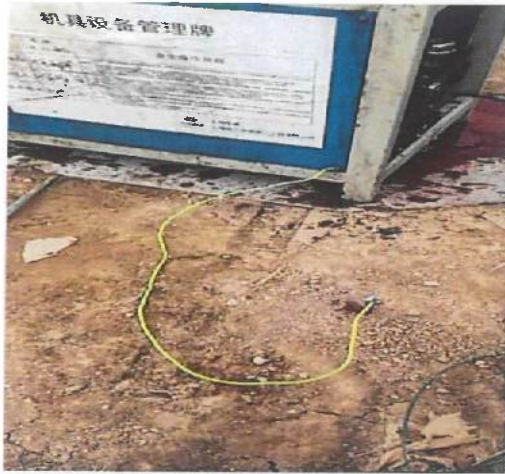
27. 加工区域配电箱接地线，接地线线径符合标准
