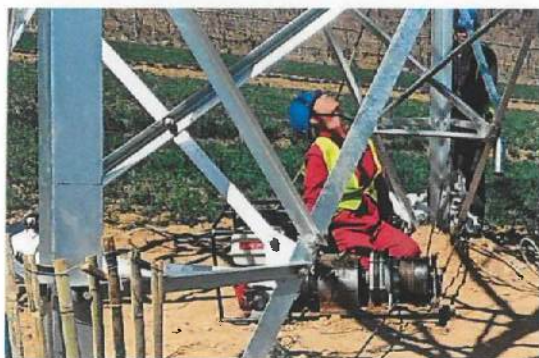
17. AB43 铁塔架线已使用防滑、防磨损措施
