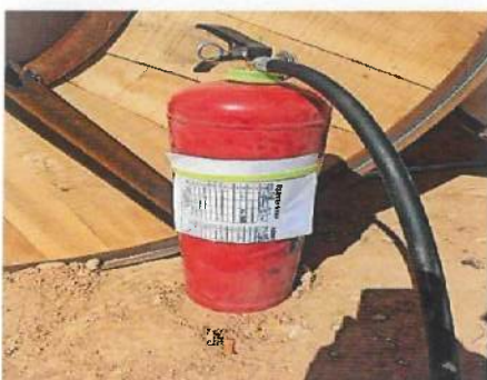
15. 已对 AB43 材料堆场灭火器进行检查, 合格
