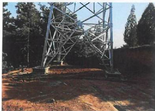
13. 西沟 C8 铁塔接地已连接
