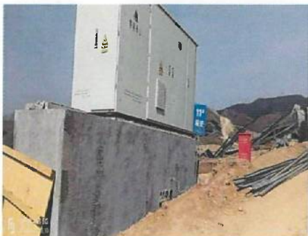
25. 11#箱变告示牌已重新立牌，已放置灭火器
