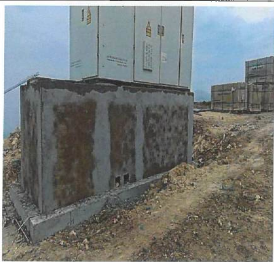
箱变基础旁边杂物清理
