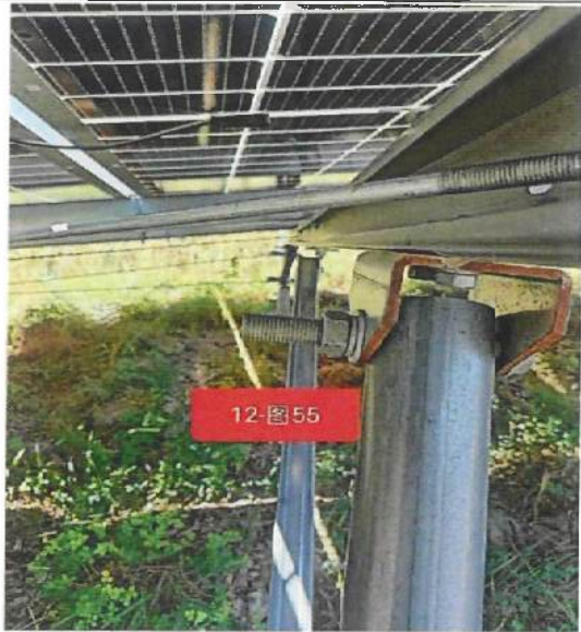
斜梁弯曲已整改
