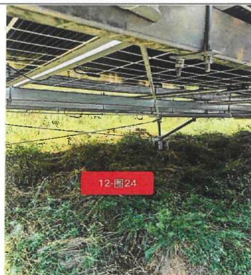
拉杆未安装已整改
