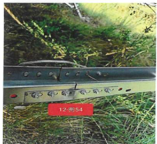
桥架变形未接地已整改
