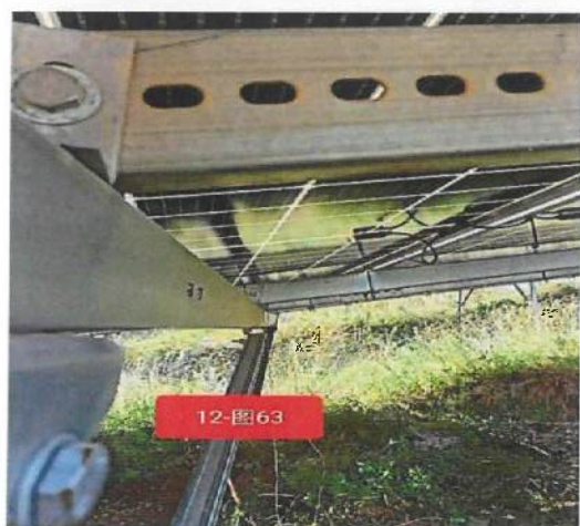
斜梁弯曲已整改
