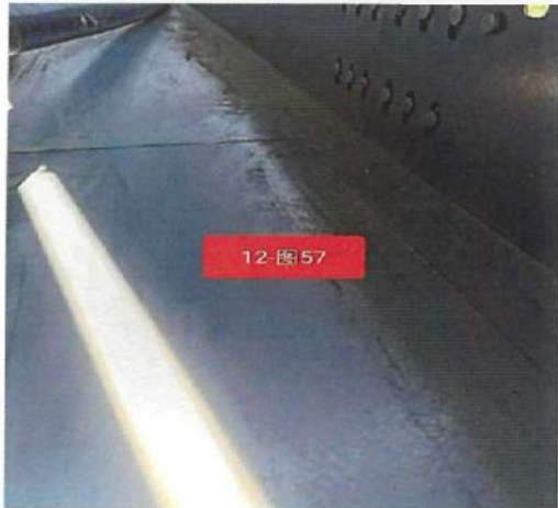
桥架连接处不平已整改
