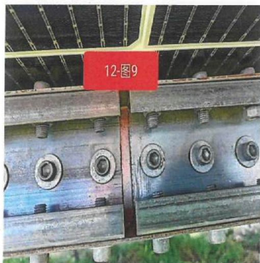
檩条连接件间隙过大已整改
