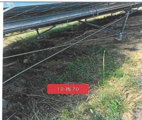
拉杆未安装已整改
