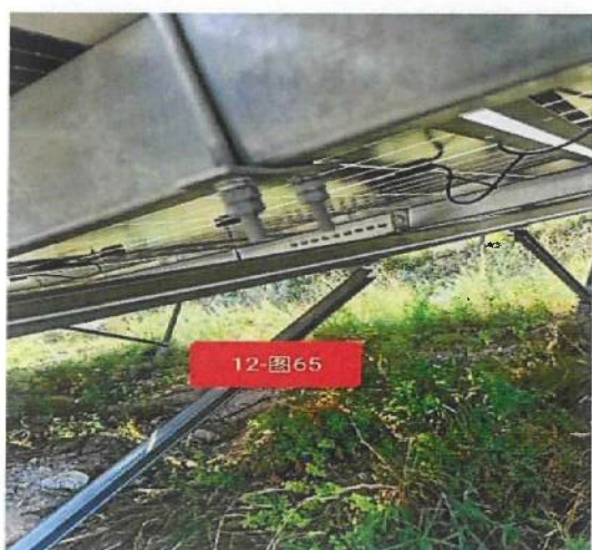
压块螺母未紧已整改
