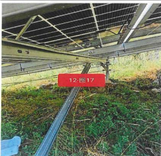
斜梁弯曲已整改
