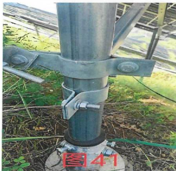
斜撑抱箍未拧紧已整改
