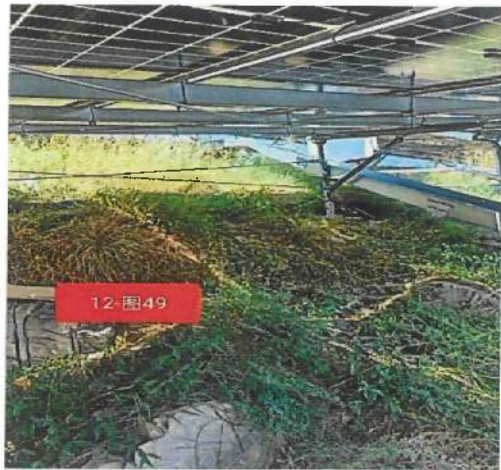
拉杆未安装已整改
