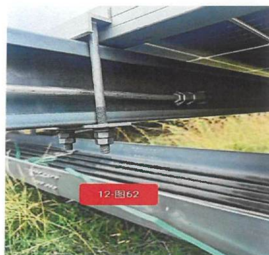
压块螺母未紧已整改
