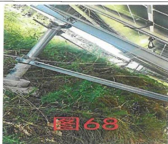
斜撑与斜梁角度过小已整改
