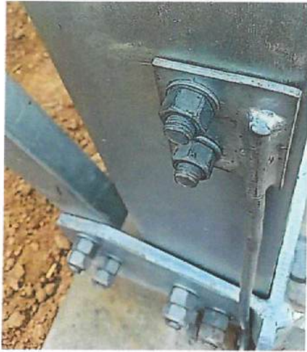
11、送出 G15 接地极与塔基间隙过大
