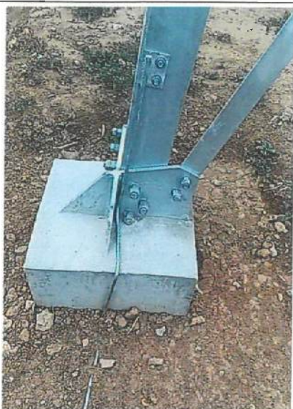
15、送出 G16 接地线断裂
