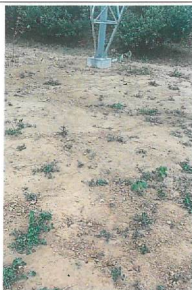
16、送出 G16 塔基底部有积水隐患
