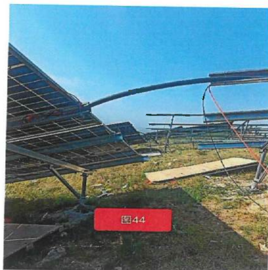
PVC 管未固定已整改
