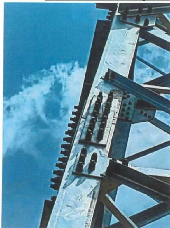
6、送出 G29 塔基螺栓过短，需更换
