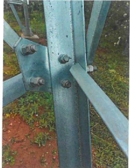
10、送出 G29 塔基防盗帽未拧紧
