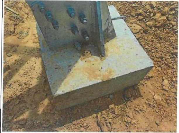
20、送出 G23 塔基保护帽需修复，塔脚缺少螺栓
