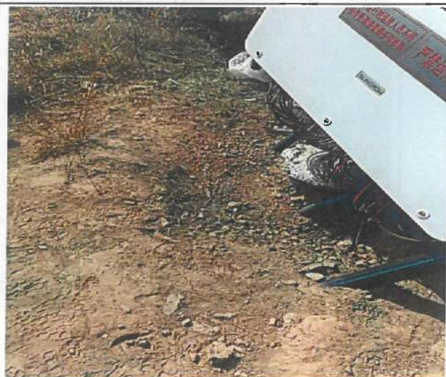
10 逆变器垃圾已清理
