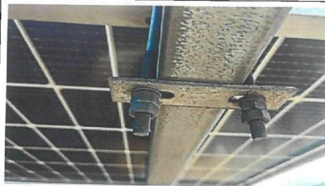
28 生锈螺母已更换
