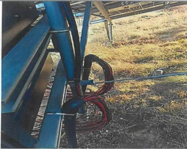
23 逆变器生锈支架已处理
