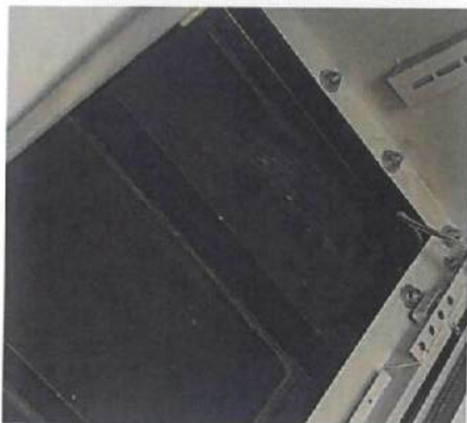
3 箱变低压侧垃圾清理
