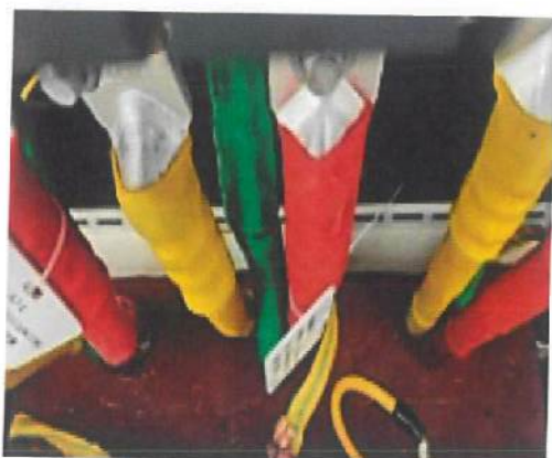
5 封堵已整改，垃圾清理
