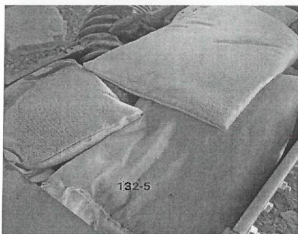
5 防火包未填满已整改
