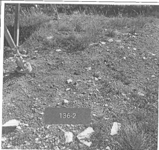
2 接地装置未做埋地处理已整改
