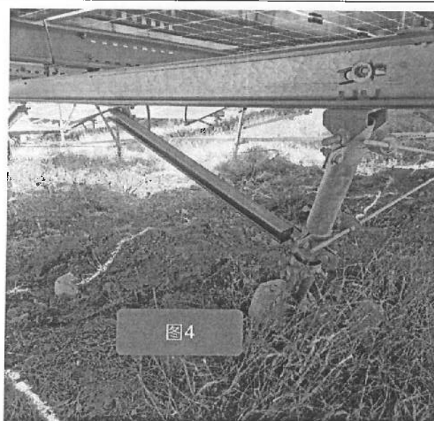
组件未回收已整改
