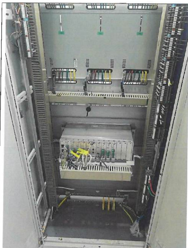
1、计量柜布线整理，网线已接入设备
