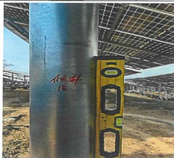
立柱倾斜已整改
