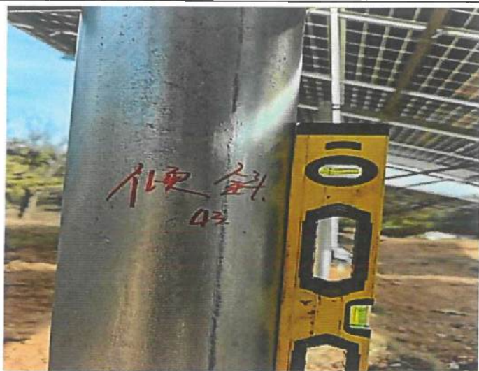
立柱倾斜已整改
