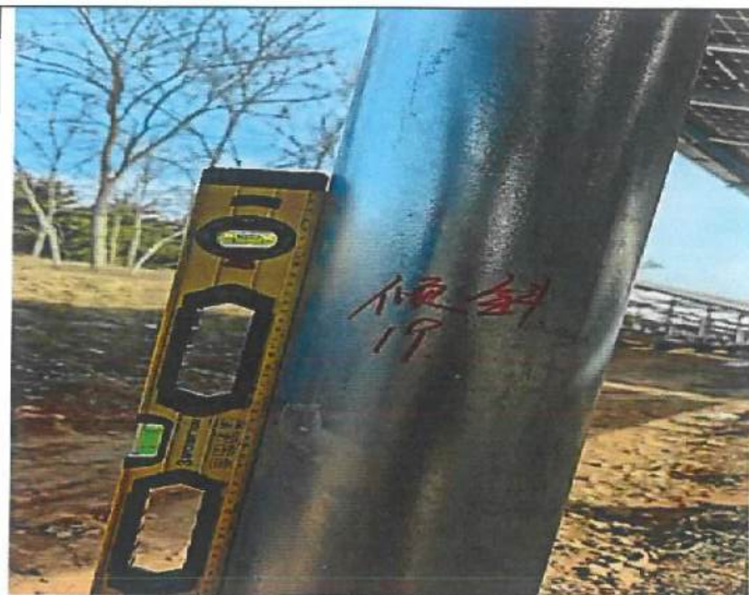
立柱倾斜已整改
