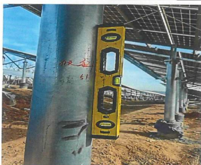
立柱倾斜已整改
