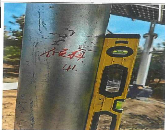
立柱倾斜已整改
