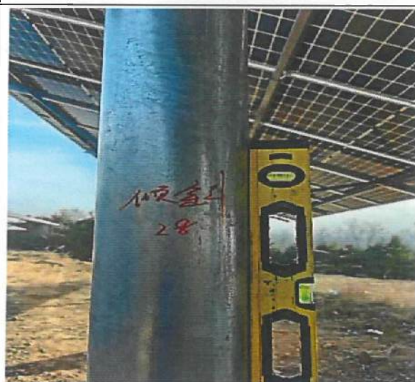
立柱倾斜已整改
