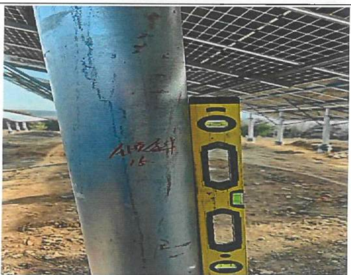
立柱倾斜已整改
