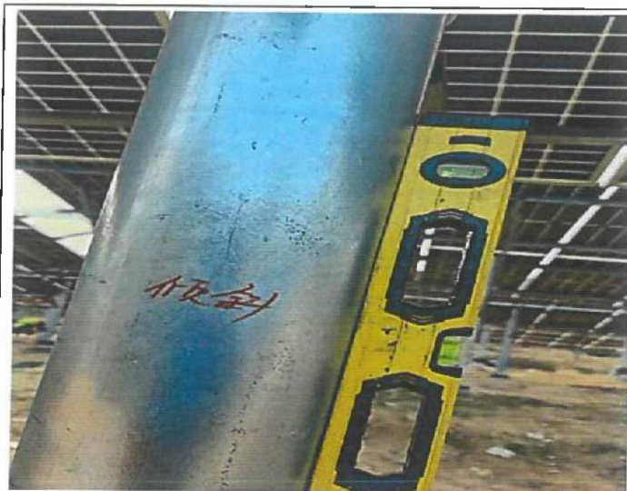
立柱倾斜已整改
