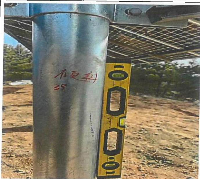
立柱倾斜已整改
