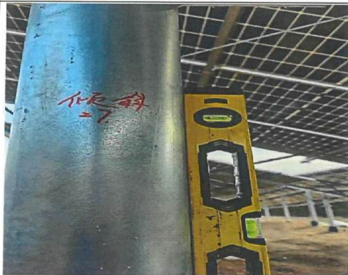
立柱倾斜已整改
