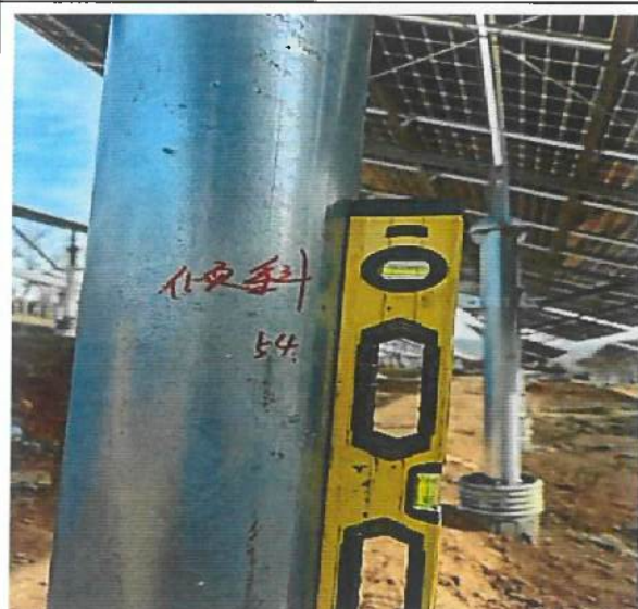
立柱倾斜已整改
