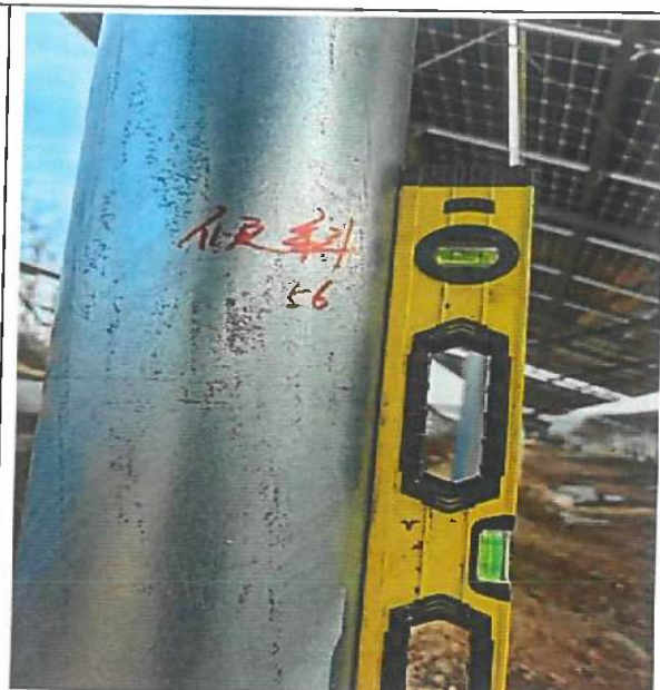
立柱倾斜已整改
