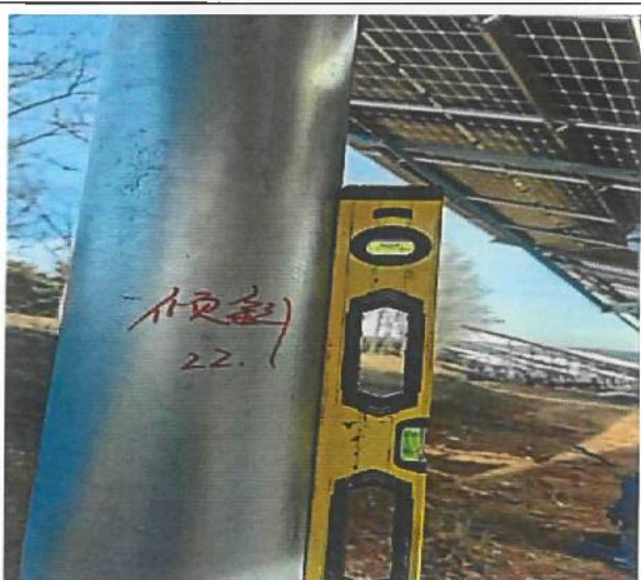
立柱倾斜已整改
