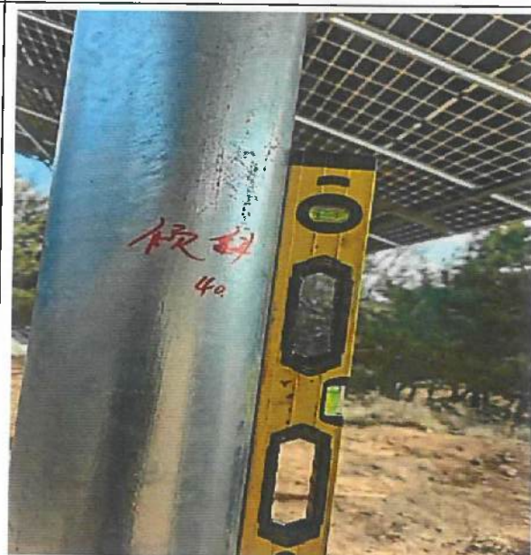
立柱倾斜已整改
