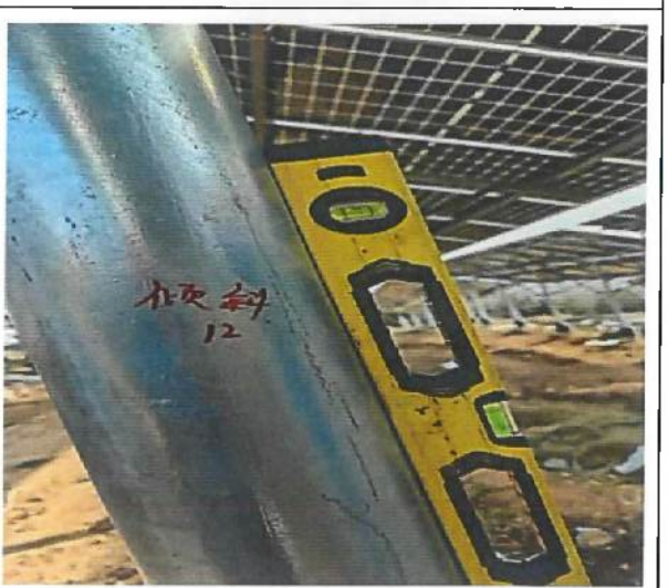
立柱倾斜已整改
