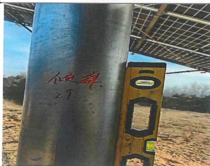
立柱倾斜已整改
