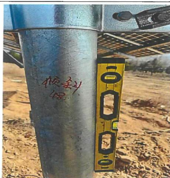
立柱倾斜已整改
