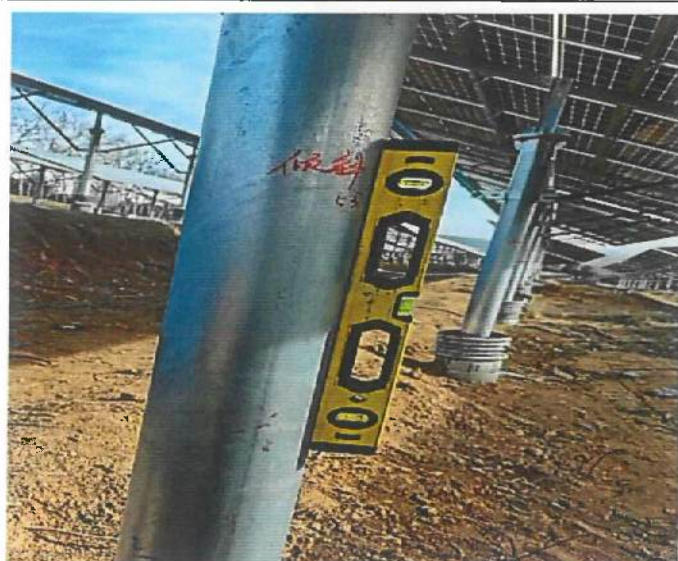
立柱倾斜已整改
