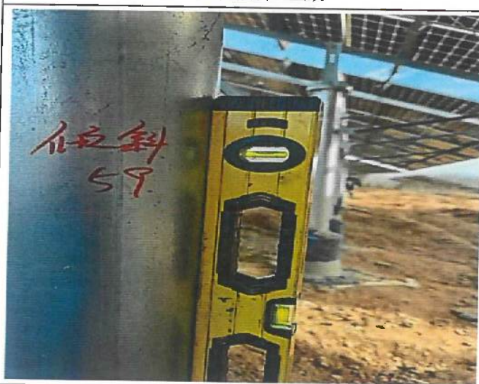
立柱倾斜已整改
