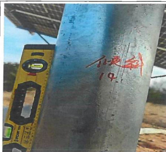
立柱倾斜已整改
