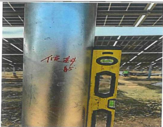
立柱倾斜已整改
