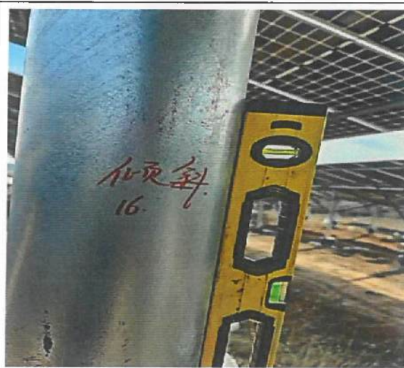
立柱倾斜已整改
