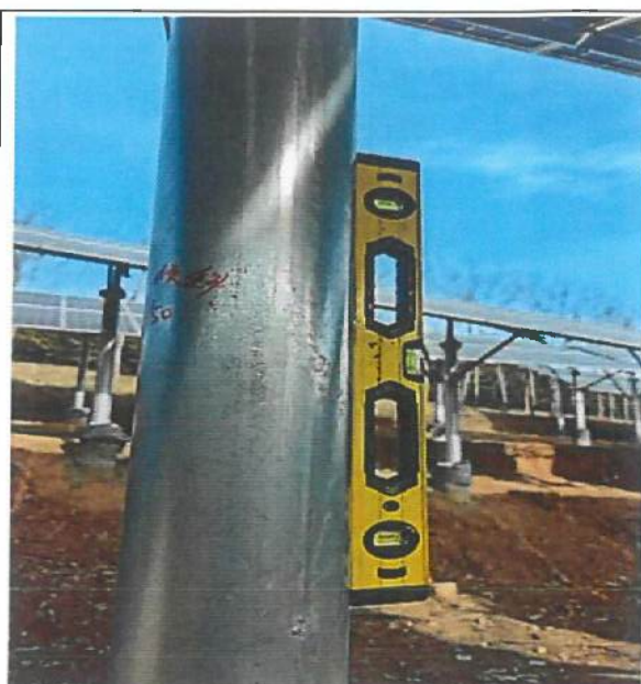
立柱倾斜已整改
