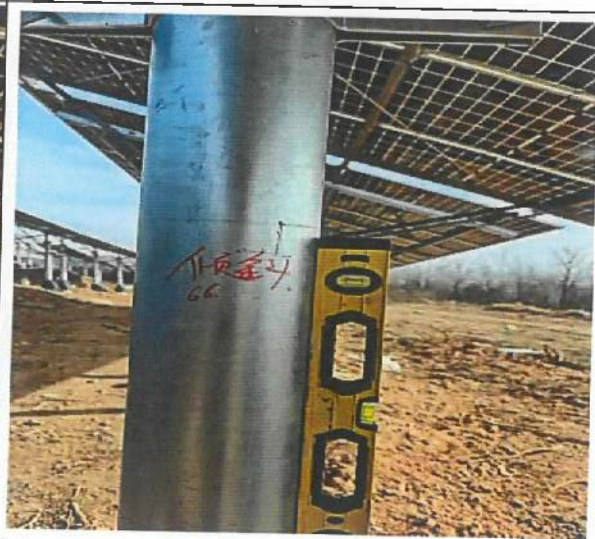
立柱倾斜已整改
