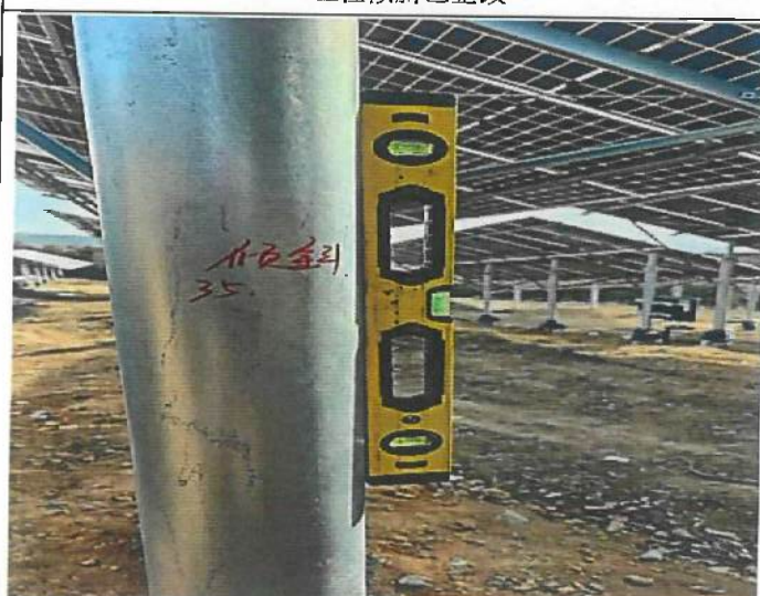
立柱倾斜已整改
