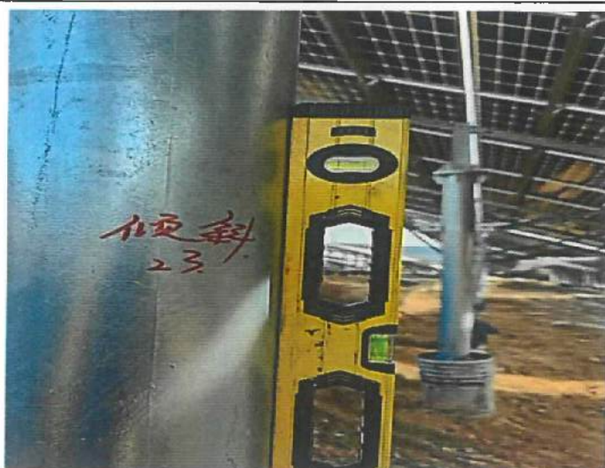
立柱倾斜已整改
