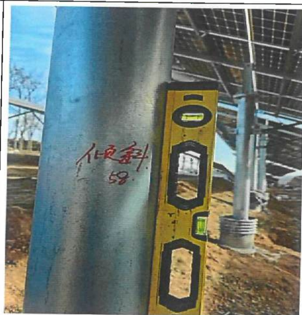
立柱倾斜已整改
