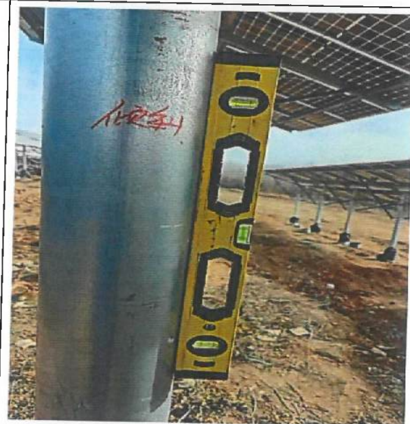
立柱倾斜已整改
