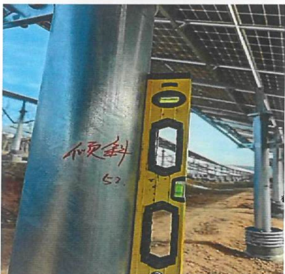
立柱倾斜已整改
