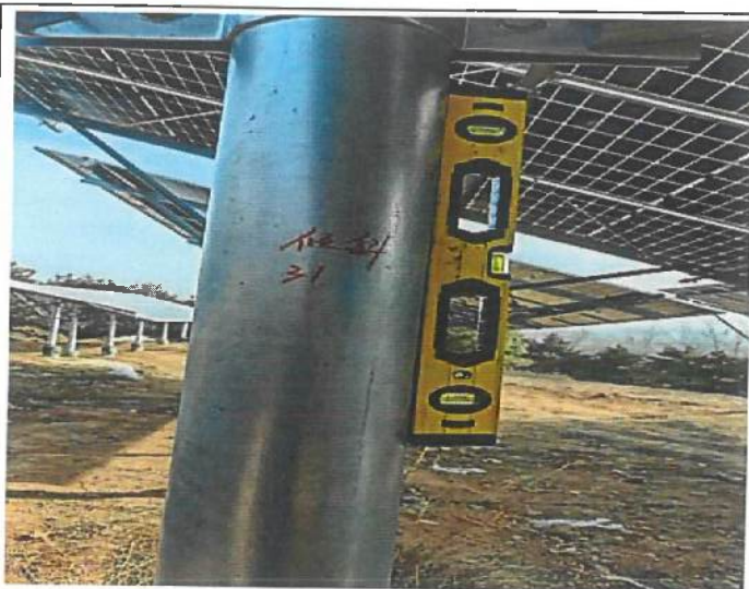
立柱倾斜已整改
