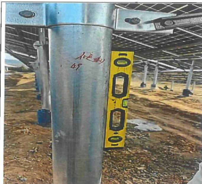
立柱倾斜已整改
