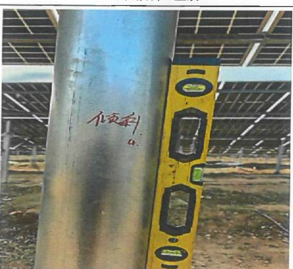
立柱倾斜已整改
