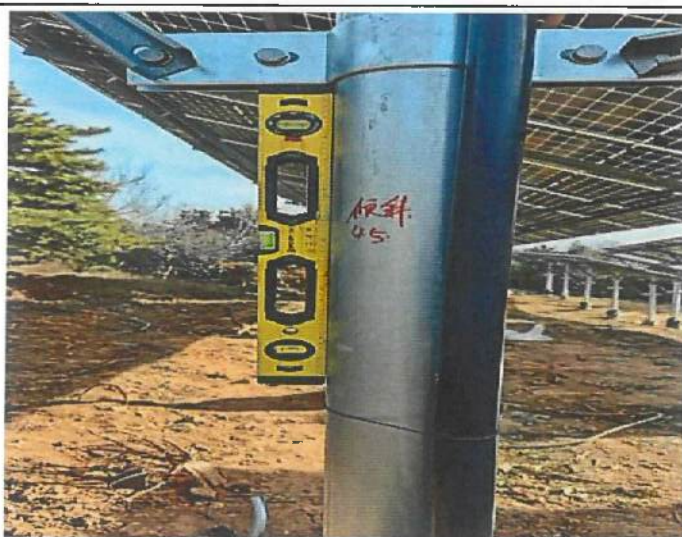
立柱倾斜已整改
