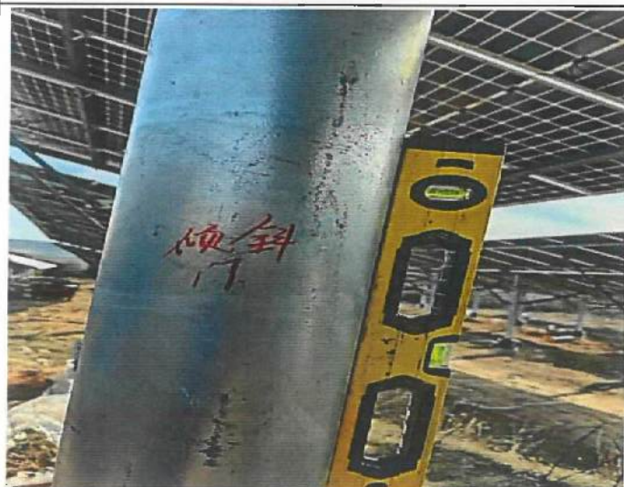
立柱倾斜已整改
