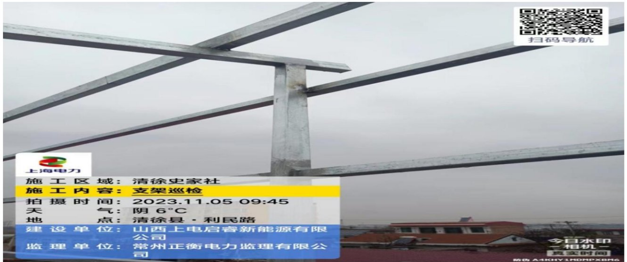
支架防锈、防腐部分无底漆
