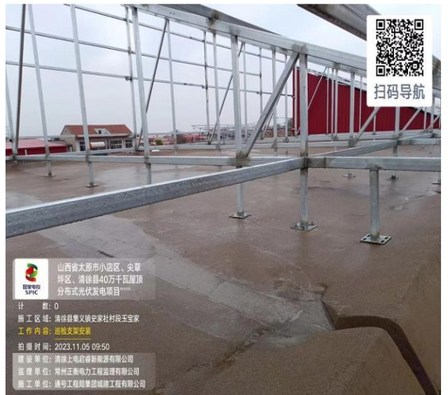
底板未做防水
