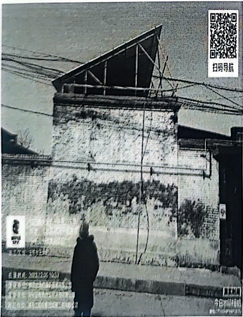
支架前立柱安装、拉筋施工不符合图纸设计要求； 横板位置未加横撑，组件安装未报验
