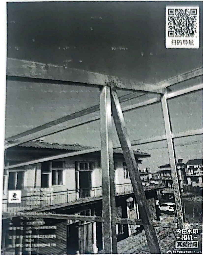
支架防腐、防锈长度不足，未刷底漆
