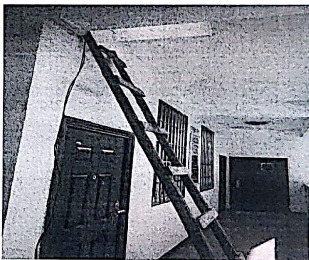
木质铁钉爬梯, 未设防滑措施
