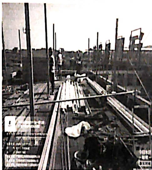
现场均未见相关安全警示标识牌
