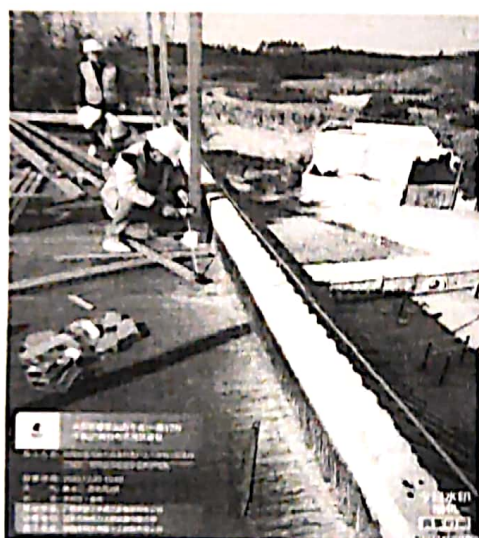
韦冬梅现场临边防护措施未落实
