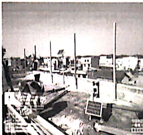
陆平伟现场临边防护措施未落实
