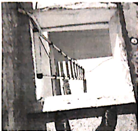
户主陆平伟现场登高梯未做相关防滑措施
