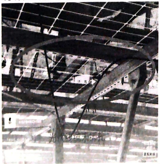
光伏线缆未绑扎
