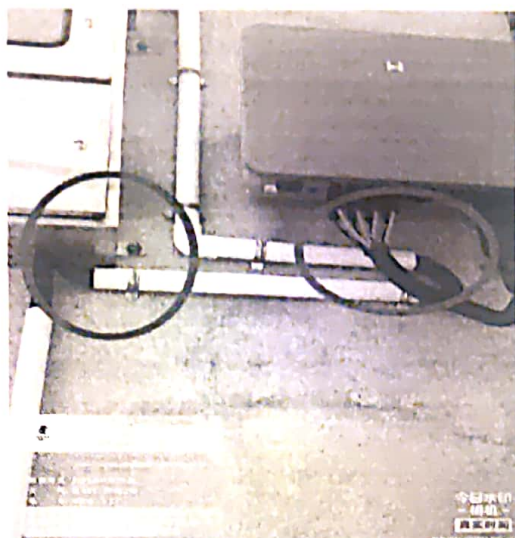
线管封堵不到位
