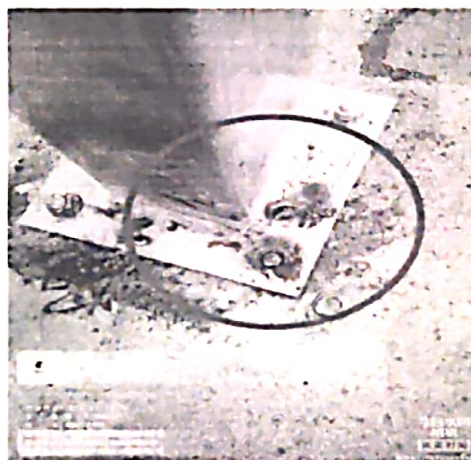
预埋螺栓被切除
