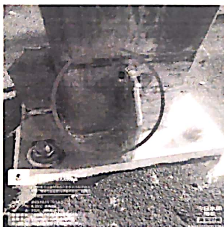
焊接处未见防腐漆
