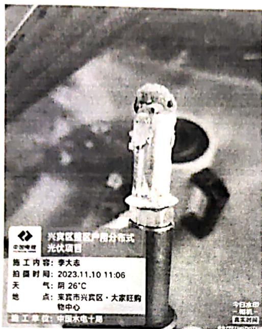
膨胀螺栓底端灰尘较多
