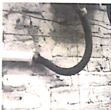
穿线管已破损
