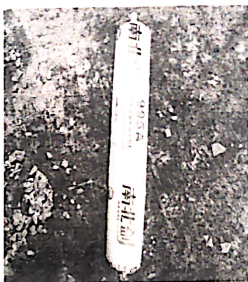
结构胶更换未报验送检
