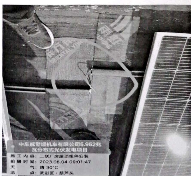
直流线穿管存在没穿到位置露线
