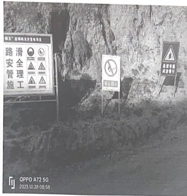
施工现场个别施工区域标识标牌缺失(图3)
