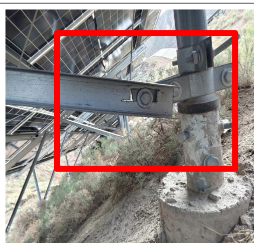
支架斜撑私自开孔安装
