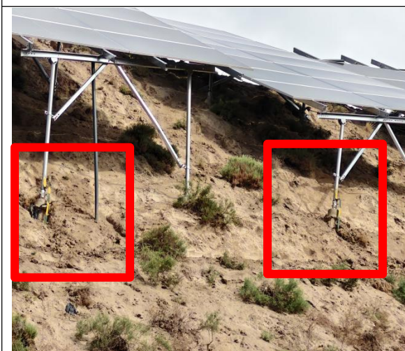
部分支架基础外露严重
