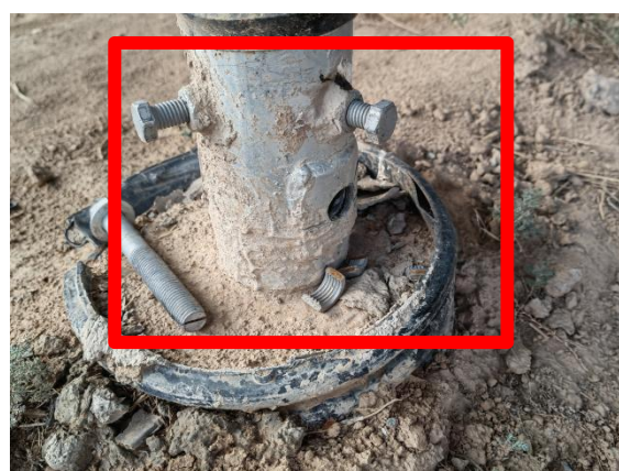
多处支架定芯螺丝未安装
