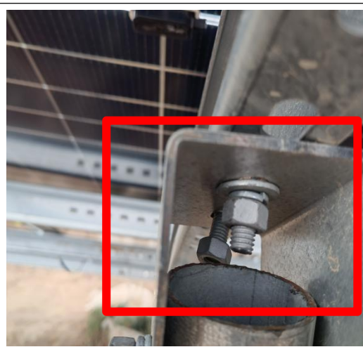
多处支架螺丝未紧固
