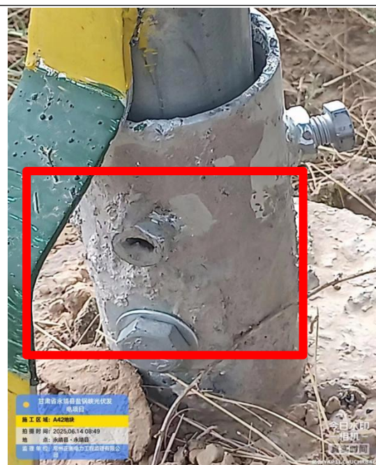
多处支架定芯螺丝未安装
