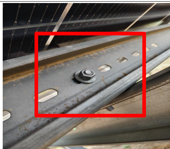
多处支架檩条、立柱、斜撑螺丝未紧固
