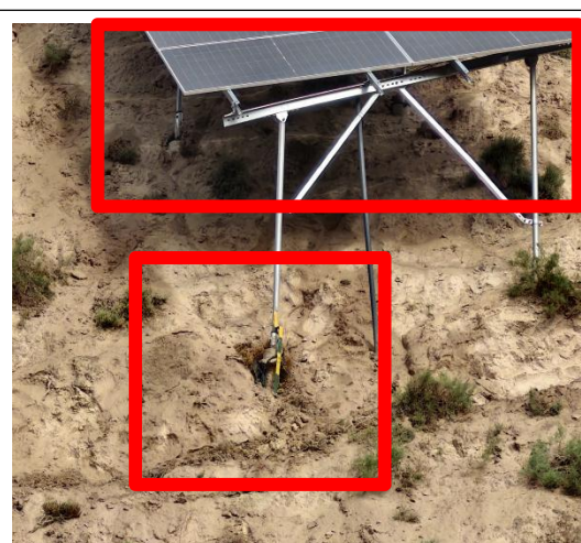
部分支架基础外露严重
