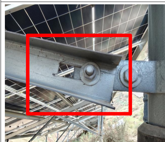
支架斜撑私自开孔安装
