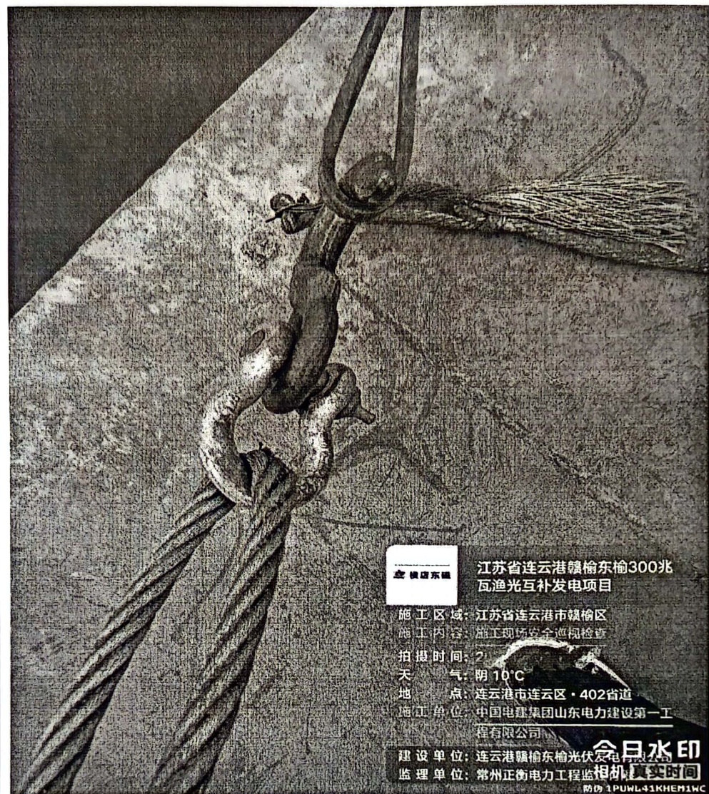
起吊设备吊钩没有防脱钩装置
