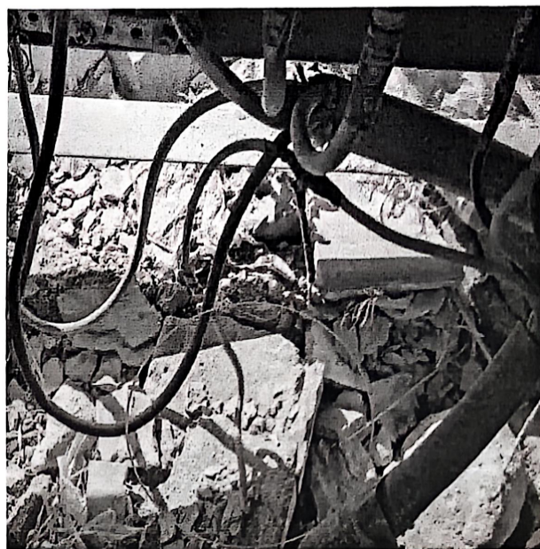
配电箱个别临时电缆的接地线未接地
