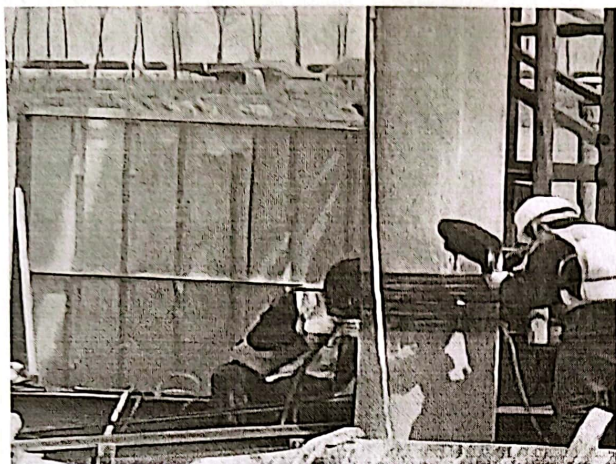
现场未见有效挡风措施
