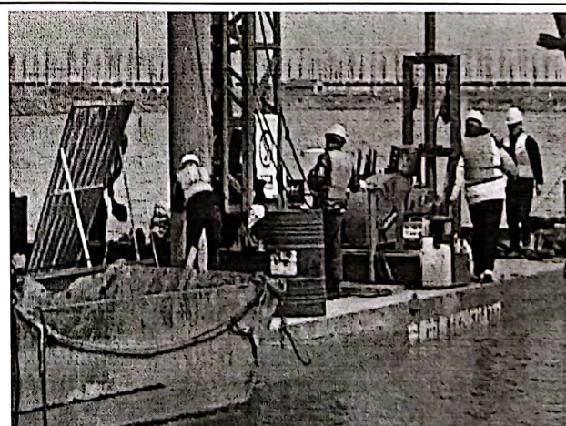
打桩船四周无安全防护措施
