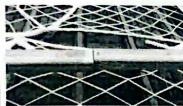
方管未安装连接件禁止铺瓦
