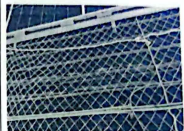
直流线缆未就近绑入组件下方支架
