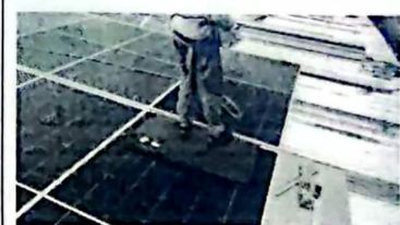
组件安装存在踩踏，尽快安排组件检测
