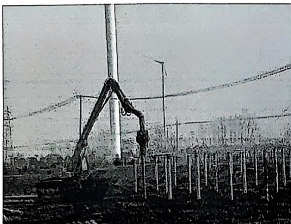
附件一：53 区桩顶标高水平已整改
