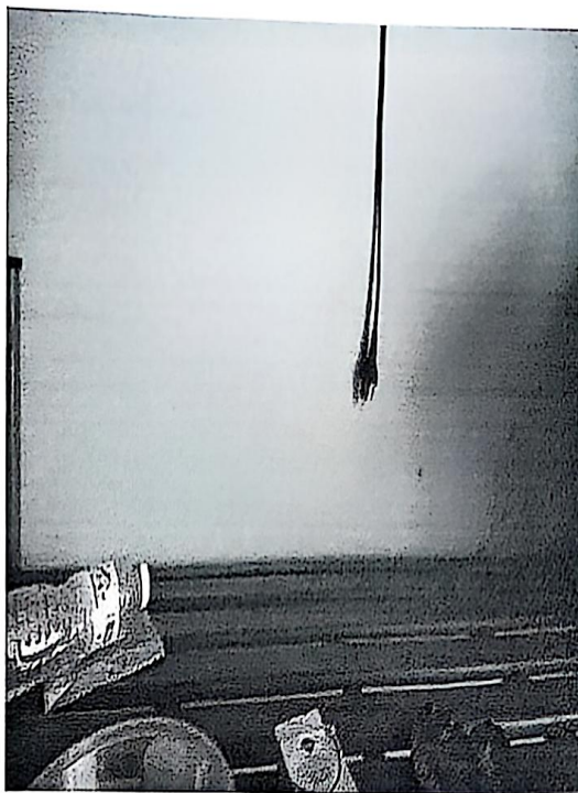
附件二：工人宿舍电线私拉乱接已整改
