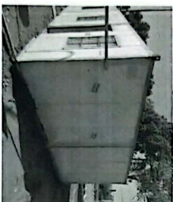
集装箱无接地装置
