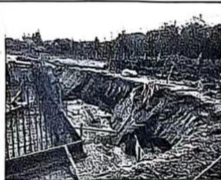
1.35KV 开关站边坡需加固
