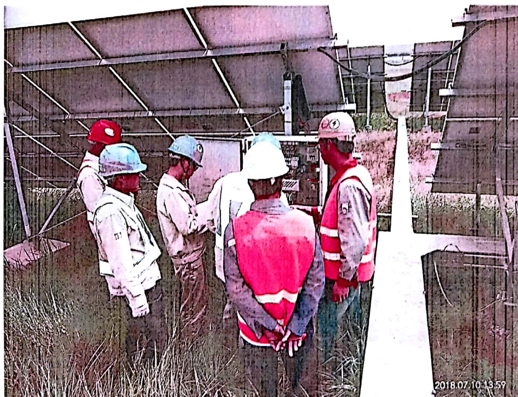
新增光伏组串开路电压测试
