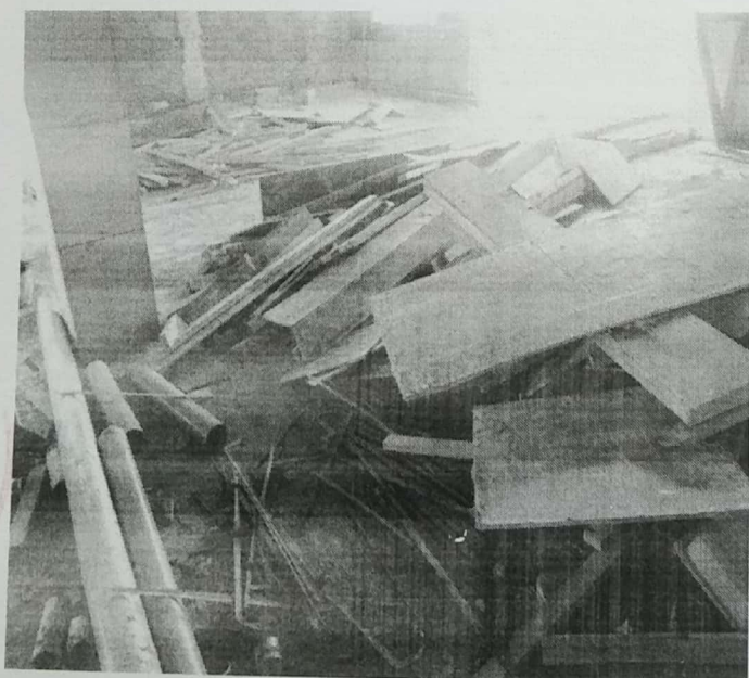
文明施工做的不到位
