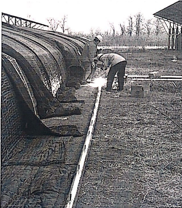
电焊作业未配置灭火器
