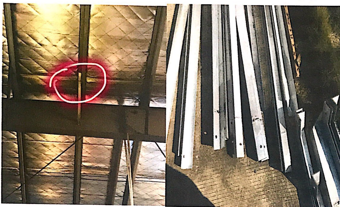
加固件（角钢）有焊接点
