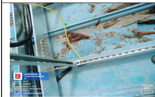
3#厂房逆变器接地连接导轨
