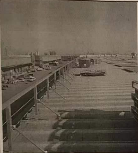
2、屋顶施工垃圾清理不及时风吹四散飘落。
