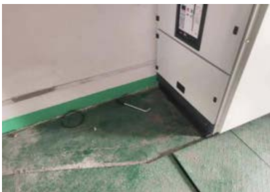
整改前：配电柜绝缘毯缺失
