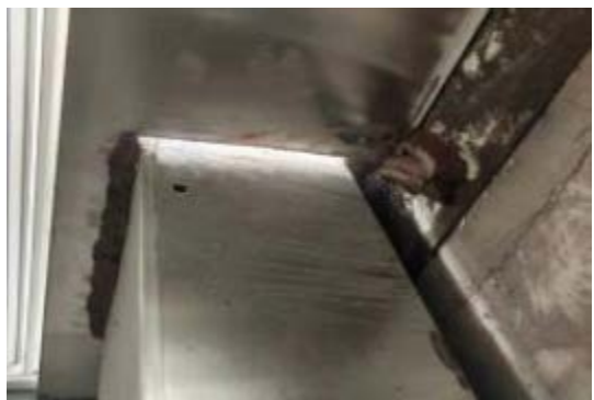
整改前：电缆桥架未封堵严密
