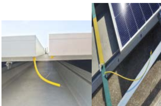
整改前：屋面个别组件接地线安装有断裂现象，不符合要求
