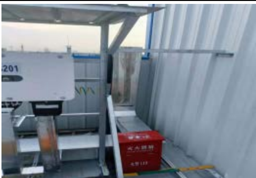
整改前：逆变器接地线接在支架上，未直接与接地母排连接
