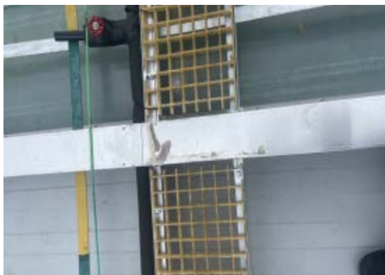
整改前：1#、2#屋面过道桥架无警示标识字 样
