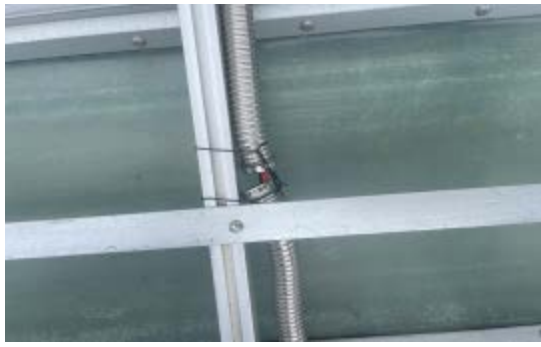
整改前：1#、2#屋面部分直流电缆金属软管 连接处不密实，有电缆外露现象
