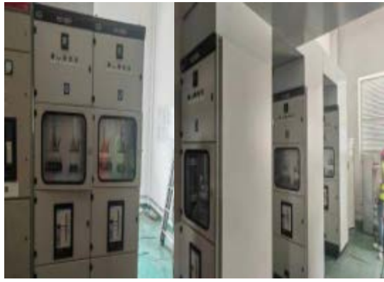
整改前：逆变器未双重命名、配电柜、元器件未双重命名、警示标志缺失、一次系统图未上墙
